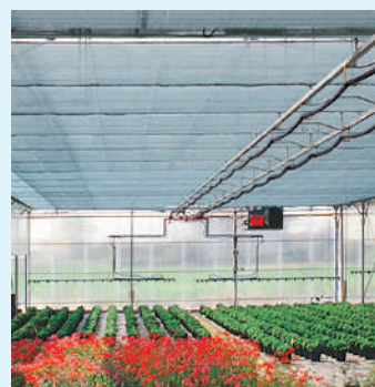
Chariot d'arrosage dans une serre avec un écran thermique . Rail supérieur en forme d'oméga pour la présence d'un générateur.
