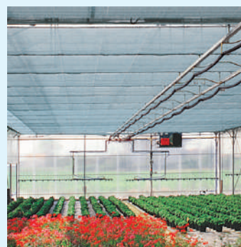
Chariot d'arrosage dans une serre avec un écran thermique . Rail supérieur en forme d'oméga pour la présence d'un générateur.
